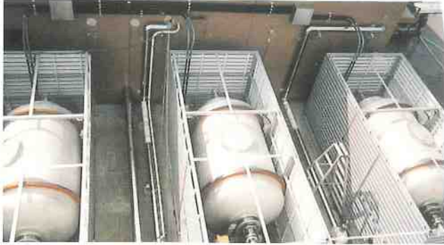
〈S病院用水浄化設備・ロータリークリーナー〉
