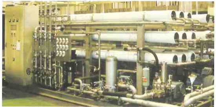
〈海水淡水化RO設備〉
